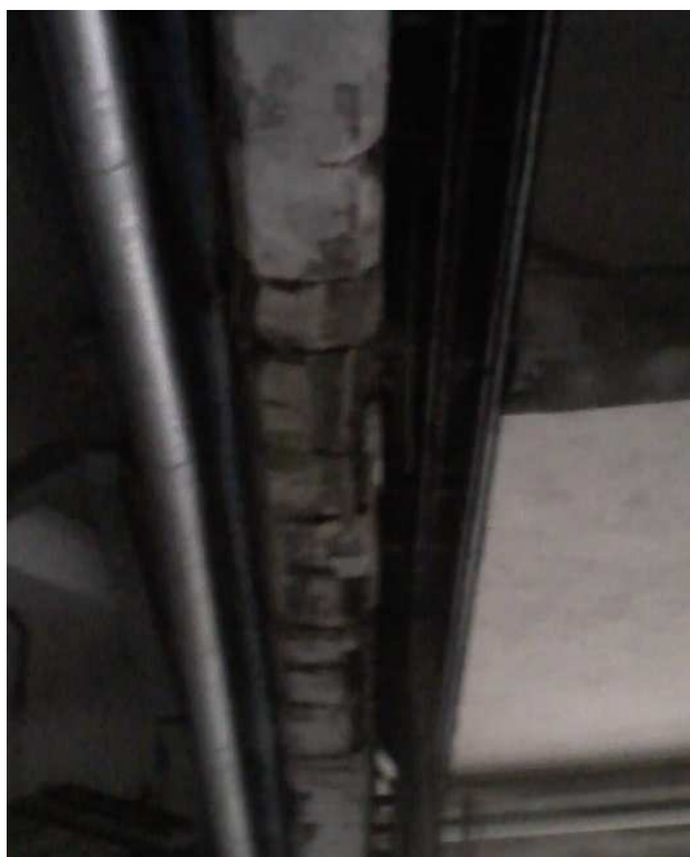
Figura 6 : esempio di trave ammalorata
